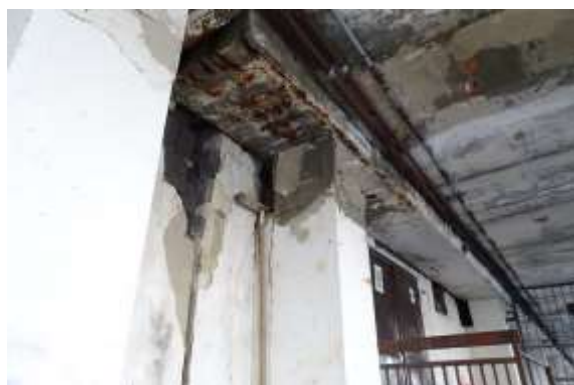
Havarijný technický stav konštrukcie
